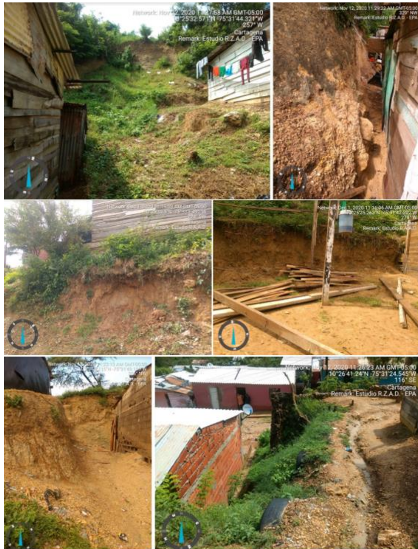
Imagen 13. Evidencias de intervención del terreno y ubicación de estructuras al pie de taludes intervenidos descontroladamente. Se resaltan los cortes verticales, la canalización de aguas de escorrentía y la ausencia de factores de contención, que juntos configuran escenarios de riesgo por deslizamiento.
