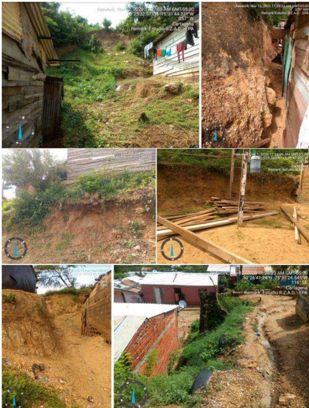
Imagen 28. Evidencias de intervención del terreno y ubicación de estructuras al pie de taludes intervenidos descontroladamente. Se resaltan los cortes verticales, la canalización de aguas de escorrentía y la ausencia de factores de contención, que juntos configuran escenarios de riesgo por deslizamiento.
