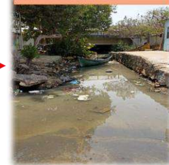
Generación de vectores y malos olores por aguas estancadas
