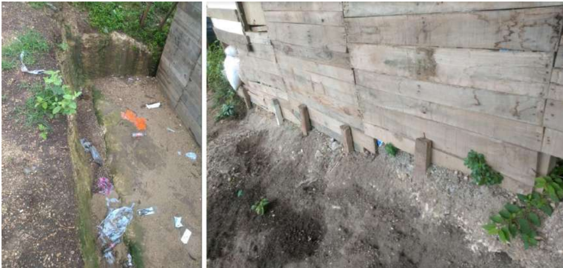
Imagen 27. Intervención del terreno a través de cortes (izquierda) y rellenos (derecha) para construcción de estructura de madera. Sector Bendición de Dios.
