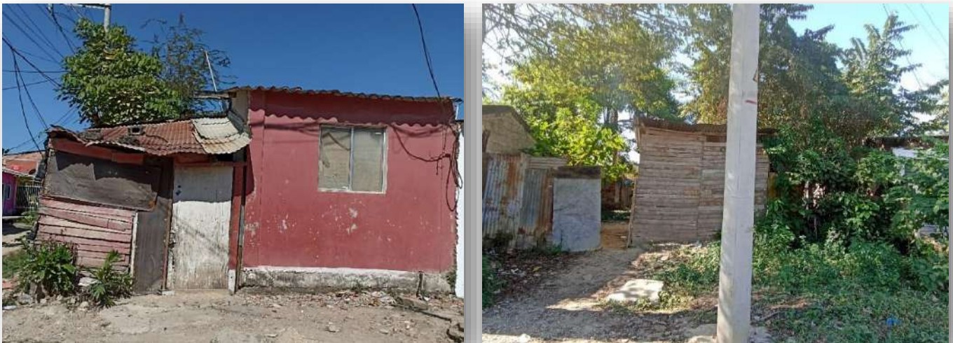
Imagen 110. Viviendas en mal estado y sin escrituración
