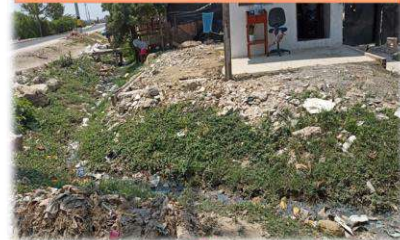
Mal estado de canales de drenajes pluviales (perdida de capacidad hidráulica)
