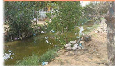
Mal estado de canales de drenajes pluviales en la desembocadura (Insuficiente capacidad hidráulica)
